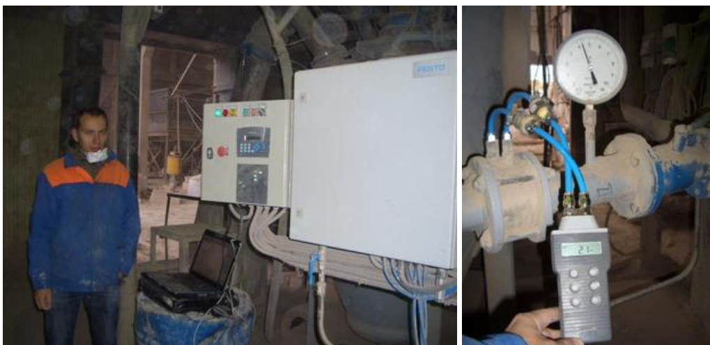
Рис.5. Наладка режимов работы. Насос оснащен сертифицированной диафрагмой для настройки минимального расхода воздуха.
