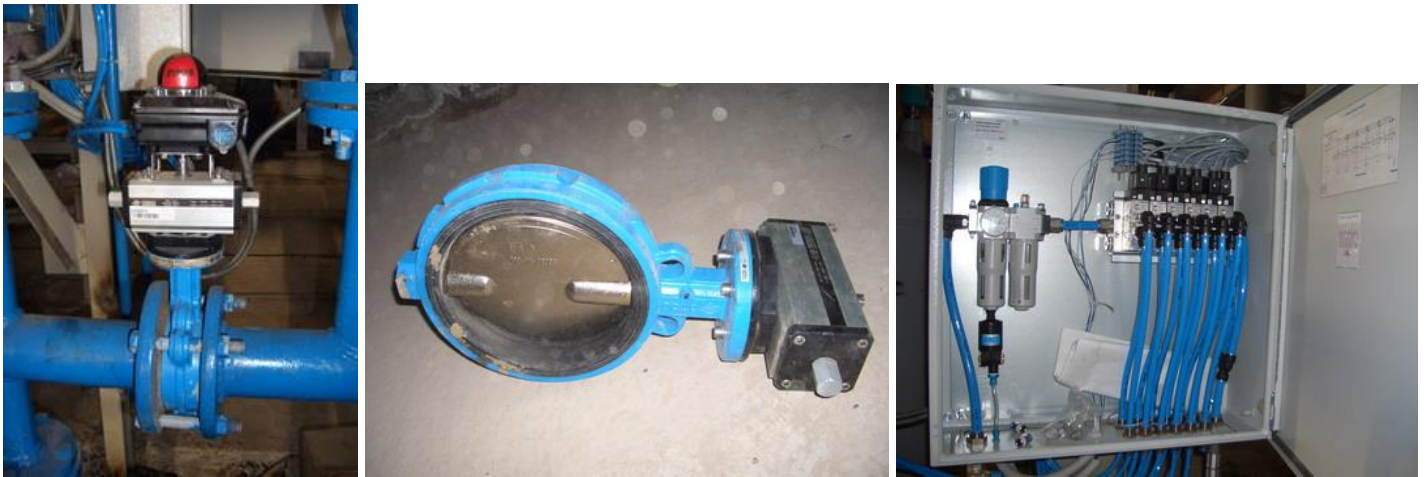
Рис.4. Насосы оснащены надежными поворотными заслонками с пневмоприводами запитываемые от пневмошкафов Festo
